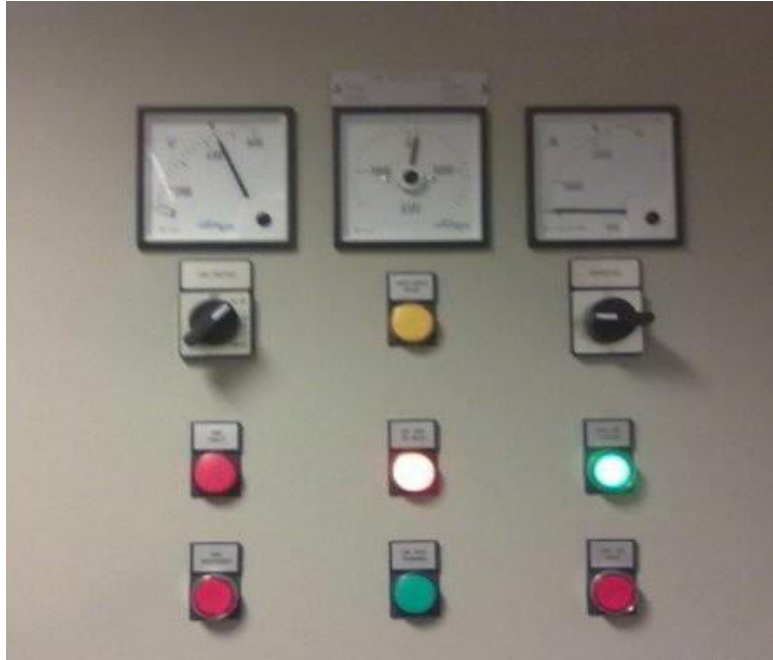
Slika 12.Kontrolni panel generatora za nuždu
