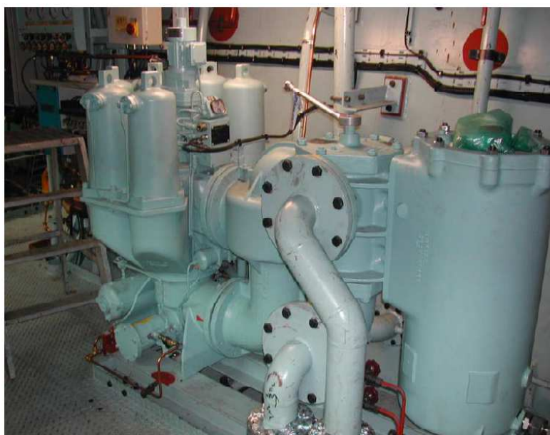
Slika 31. Automatski filtar sistemskog ulja prije usisa kontrolnih i servo pumpi [2]
