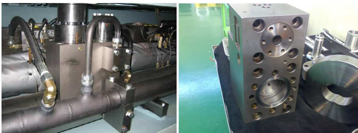
Slika 28. Ugrađena VCU jedinica i njene spojnice [2]
