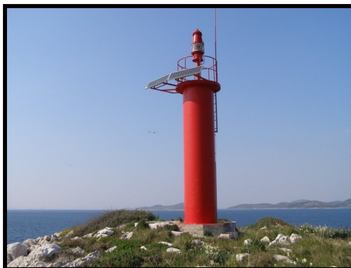
Slika 25 Obalno svjetlo sa ugrađenim solarnim panelima za napajanje
