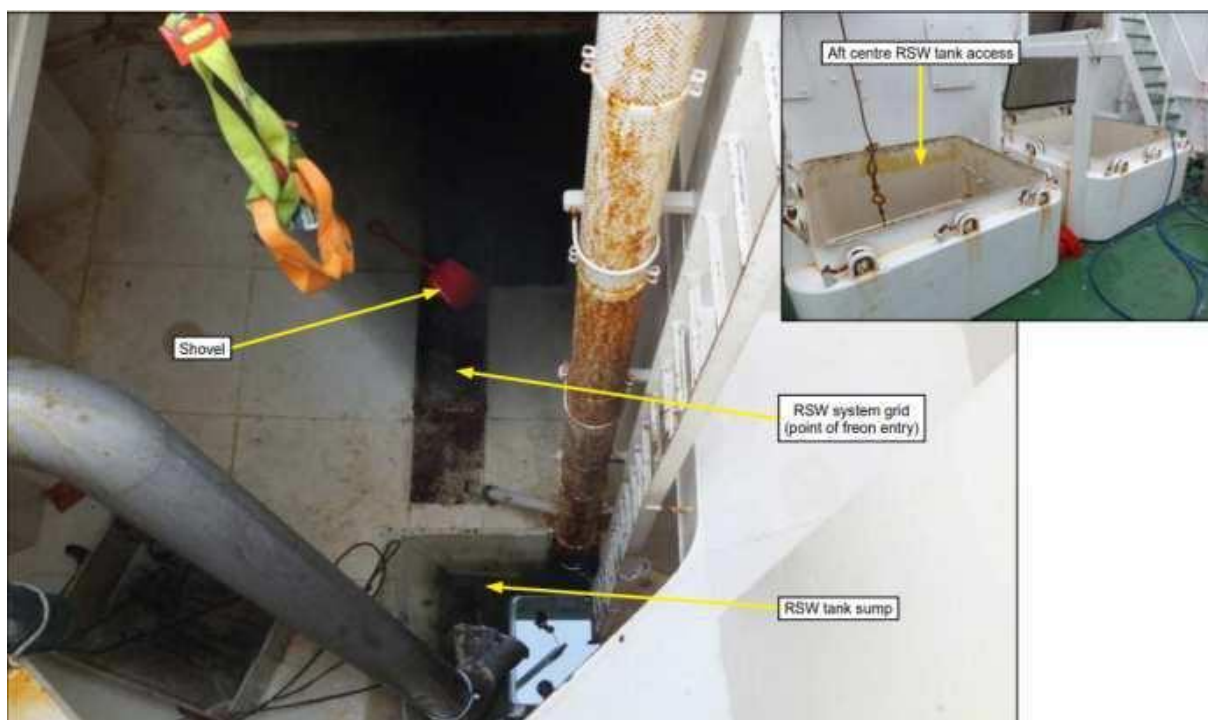
Slika 9: Krmeni centralni RSW tank
