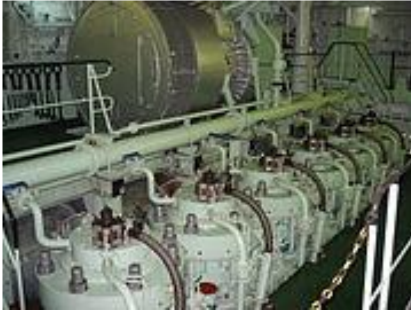
Slika 15. Glavni pogonski stroj kontejnerskog broda
