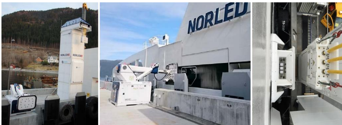
Slika 24: CAVOTEC APS vertikalno automatsko sučelje sustava kopnenog priključka na ro-ro putničkom brodu „Ampere“; Kopneni dio sučelja (lijevo); Vakuumski sustav za automatsko pristajanje (sredina); Brodski dio sučelja (desno) Izvor: Adaptirano iz [96]
