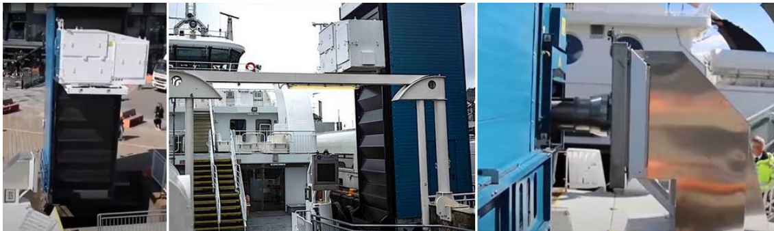
Slika 25: CAVOTEC APS horizontalno automatsko sučelje sustava kopnenog priključka na ro-ro putničkom brodu Prinsen ; Kopneni dio sučelja (lijevo); Pozicija automatskog sučelja netom nakon pristanka (sredina); Spoj kopnenog i brodske dijela sučelja (desno) Izvor: Adaptirano iz [107], [108]
