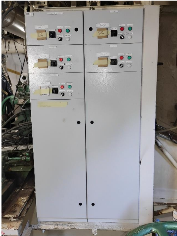
Slika 34. Ormari montirani na operativno mjesto.
