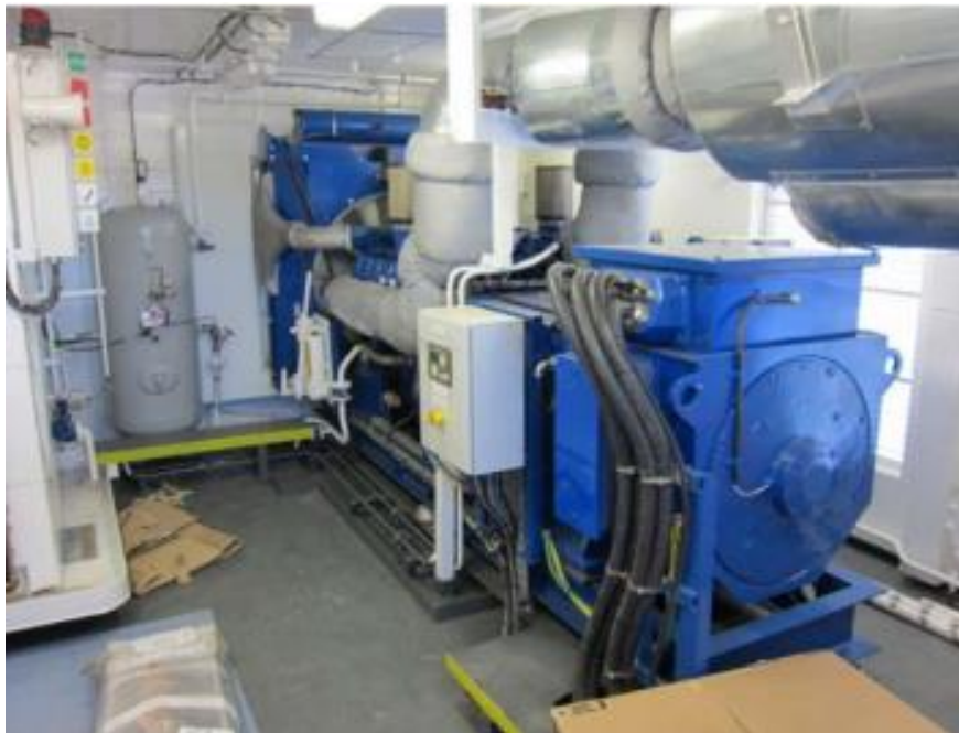
Slika 8 Generator za nužnost
