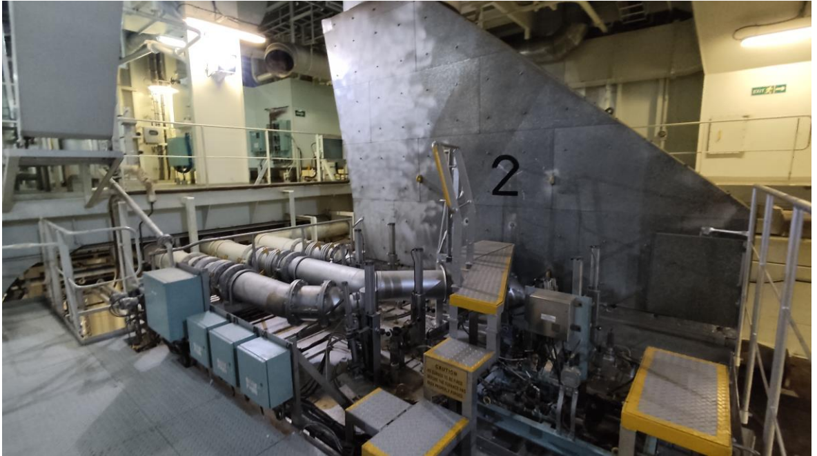
Slika 8: Gorači na generatoru pare s cjevovodom goriva [9]
