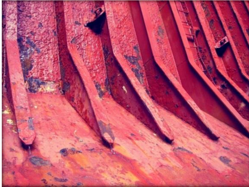
Slika 23: Korozija u skladišnom prostoru
