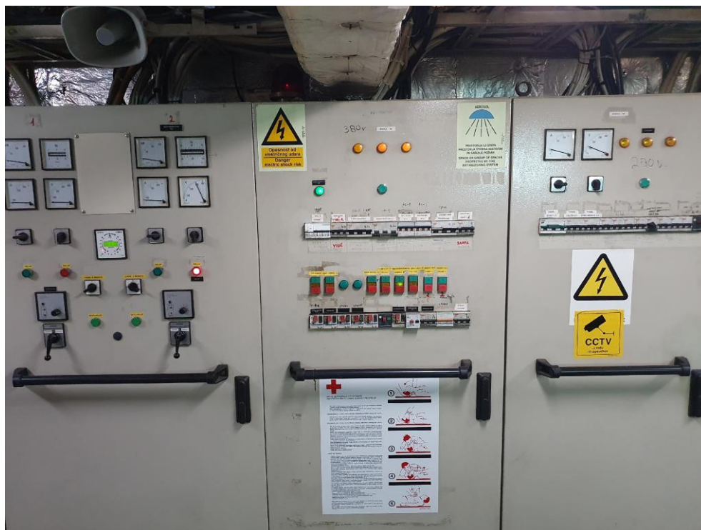
Slika 7. Glavna rasklopna ploča trajekta “Lošinj”
