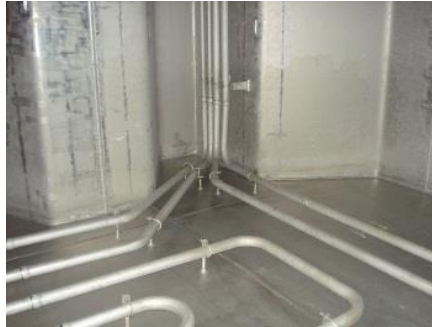
Slika 1. Sustav cijevi (tzv. „serpentina“) za grijanje tereta Izvor: https://captajitvadakayil.in/2021/02/11/steam-heating
