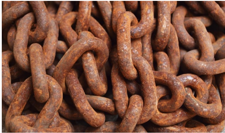
Slika 1. Opća korozija čeličnog lanca
