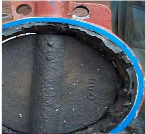
Slika 15. Neispravni ventil cjevovoda
