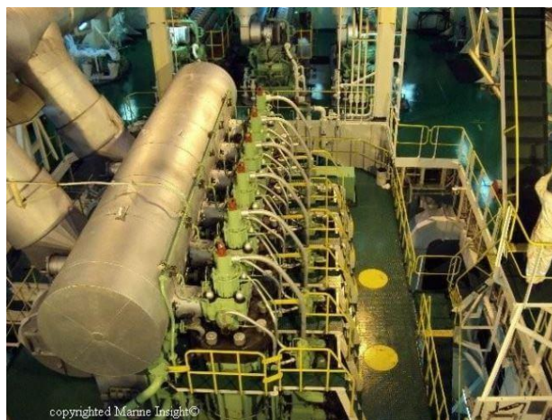
Slika 9. Pogled na pogonski stroj odozgor
