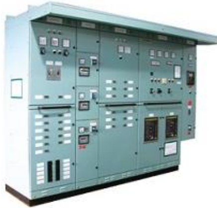
Slika 7 Rasklopna ploča u nuždi
