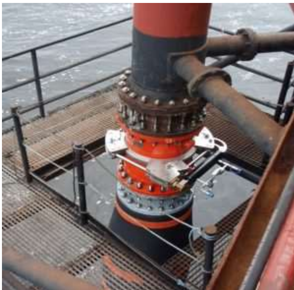
Slika 14. Primjer primjene ERSOC sustava na FPSO plovilu u zapadnoj Africi
