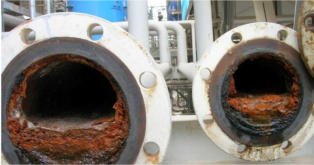
Slika 15: Ostatci u dobavnim cijevima morske vode bez korištenja MGPS sistema
