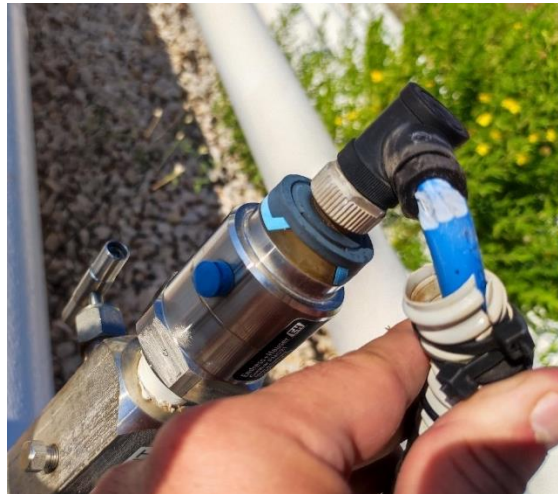
Slika 21.Primjer: Nedostatak – oštećeni instrumentalni kabel
