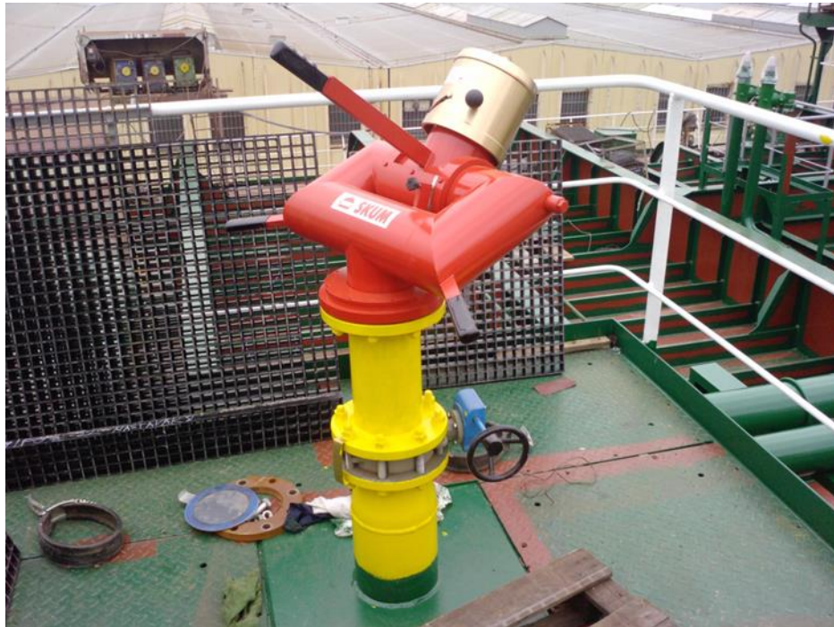
Slika 8 Monitor za gašenje požara na palubi
