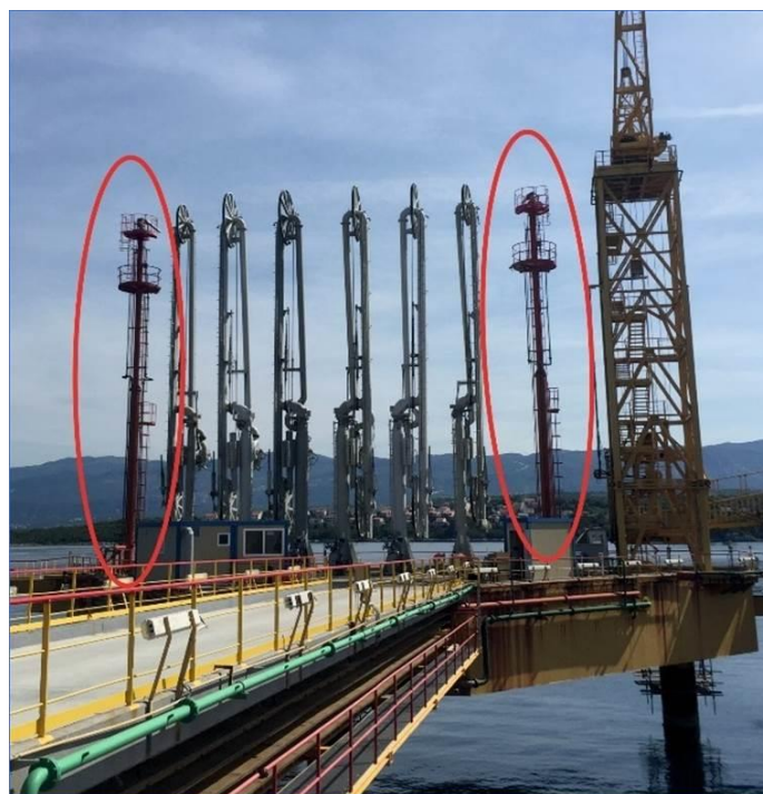
Slika 18 Protupožarni tornjevi na terminalu JANAF
