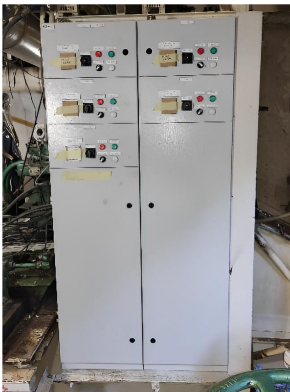
Slika 34. Ormari montirani na operativno mjesto.
