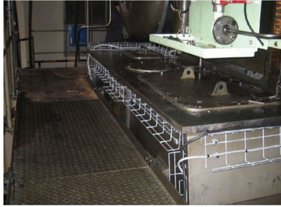
Slika 18. Kabelski nosač na glavnom motoru
