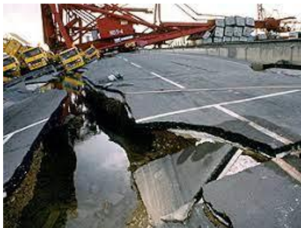
Slika 9 Cesta uništena zbog potresa
