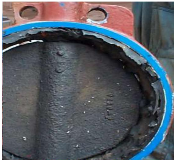
Slika 15. Neispravni ventil cjevovoda
