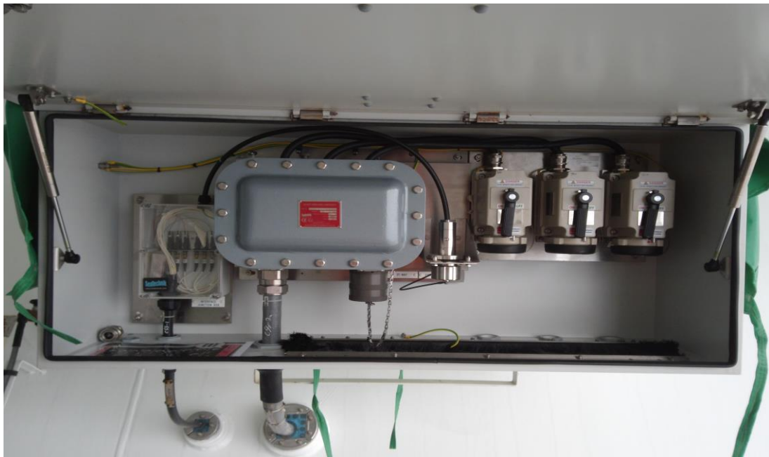
Slika 21: priključna kutija ESD-a FSRU Hoegh Giant
