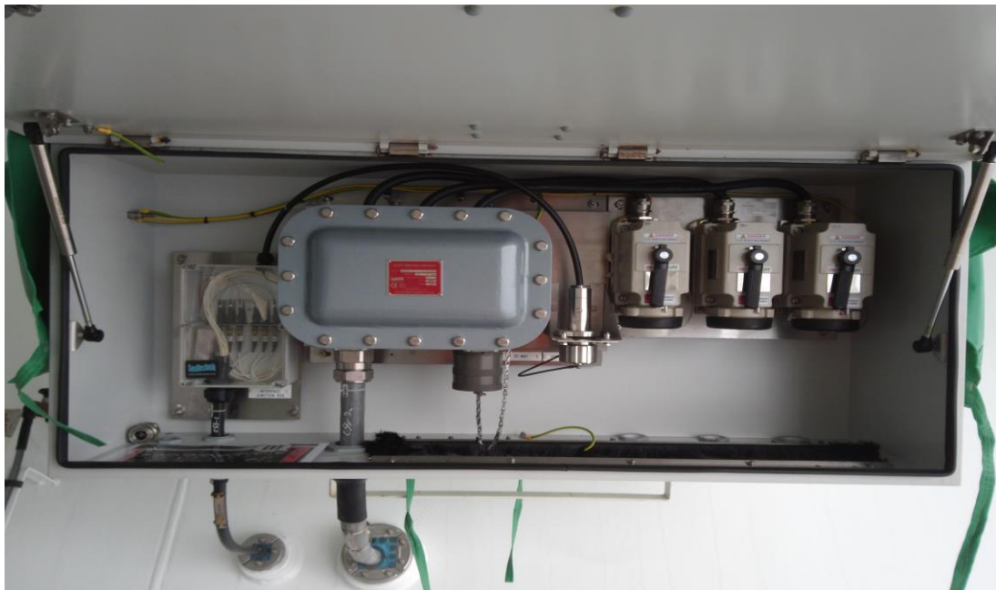
Slika 21: priključna kutija ESD-a FSRU Hoegh Giant
