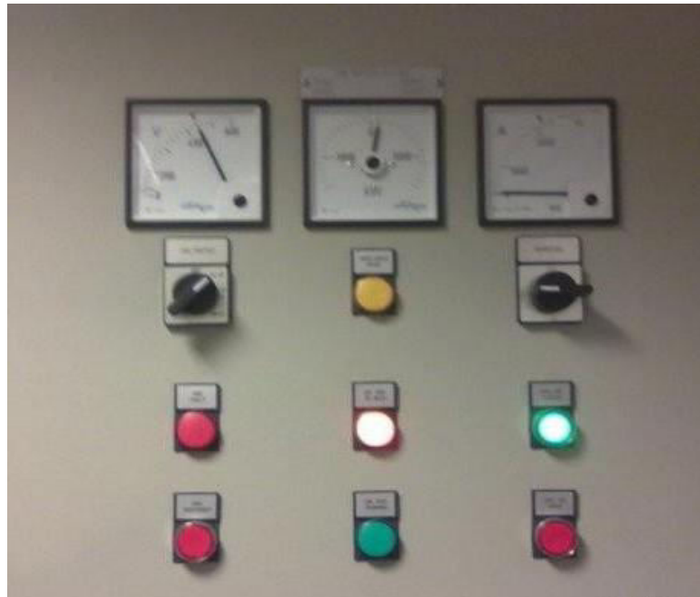
Slika 12.Kontrolni panel generatora za nuždu
