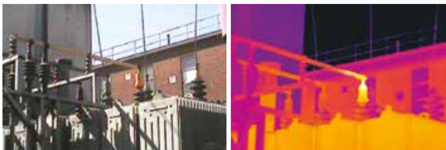
Slika 12. Prikaz visoke temperature na trafostanici pomoću termovizije
