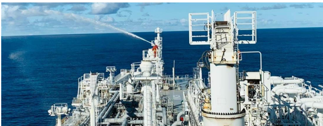
Slika 12 Održavanje protupožarnog sustava na brodu
