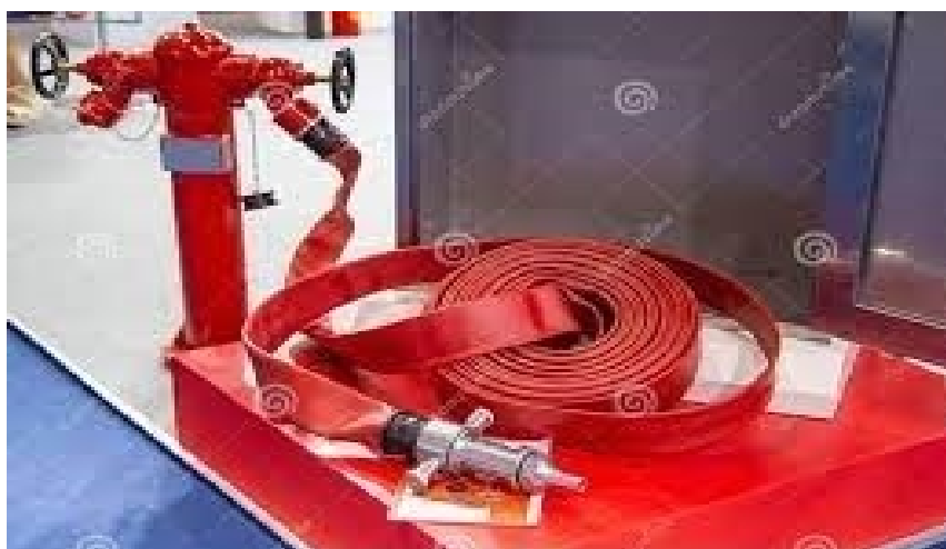
Slika 9. Protupožarna cijev spojena na hidrant
