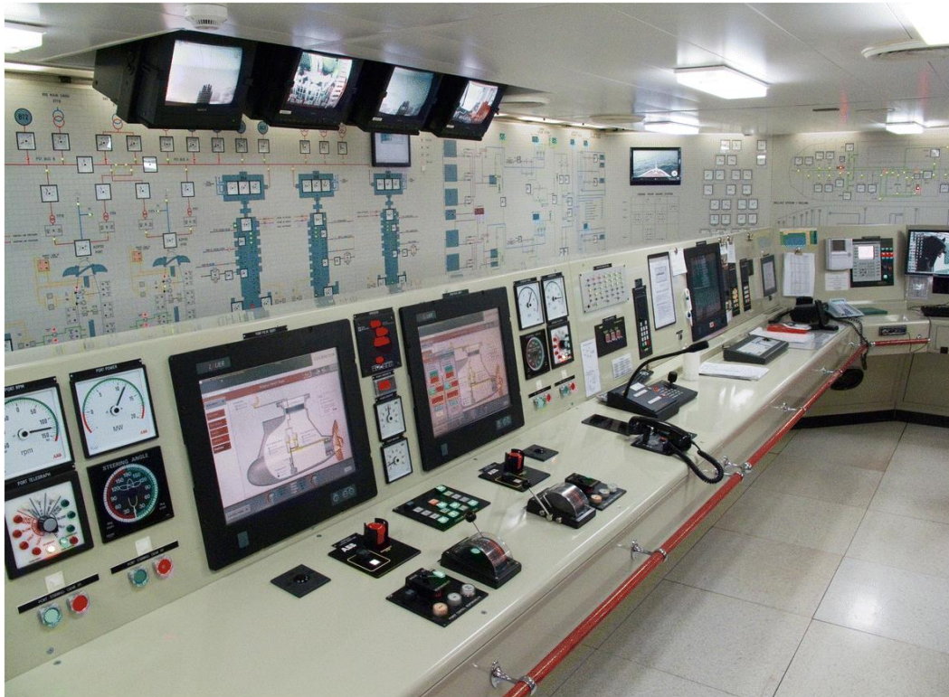
Slika 12: Kontrolna soba strojarnice (Engine Control Room)
