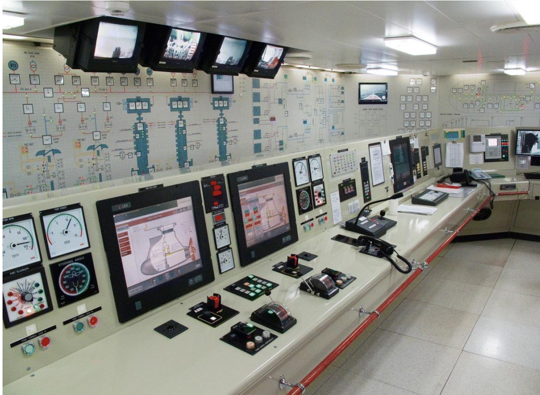
Slika 12: Kontrolna soba strojarnice (Engine Control Room)
