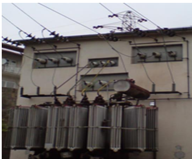
Slika 2. Fotografski prikaz trafostanice, naponskog nivoa 35/10 kV/kV
