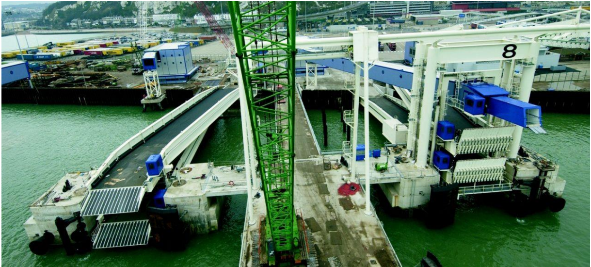
Slika 15. Mosna rampa za prihvat dva broda istovremeno
