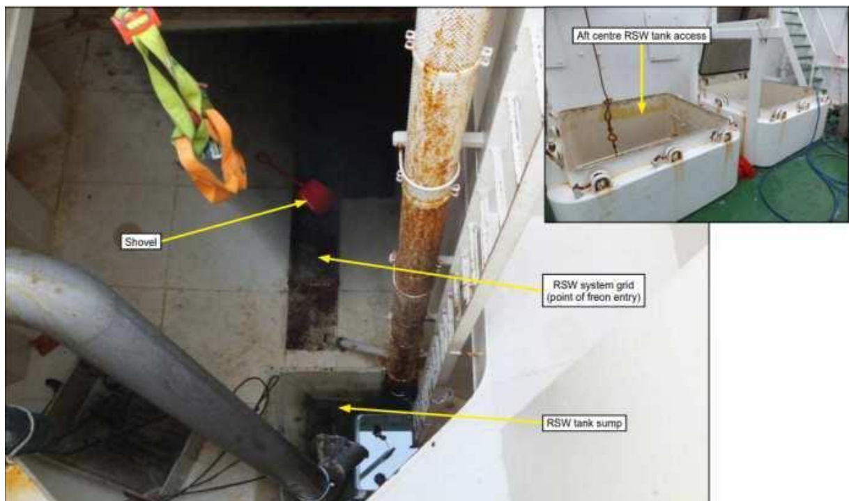
Slika 9: Krmeni centralni RSW tank
