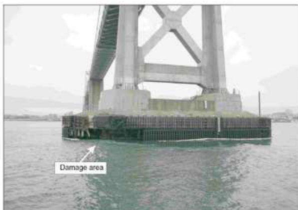
Slika 18. Prikaz oštećenja Delta tornja[15]
