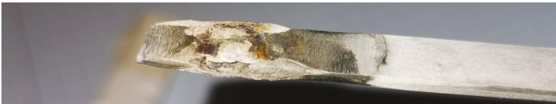
Slika 12. Korozija zavara koji nije pasiviziran
