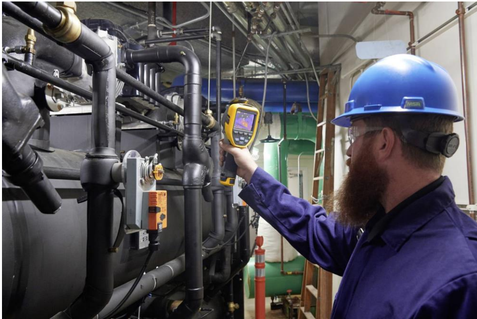
Slika 22-Primjer nadzora sustava termovizijskom kamerom
