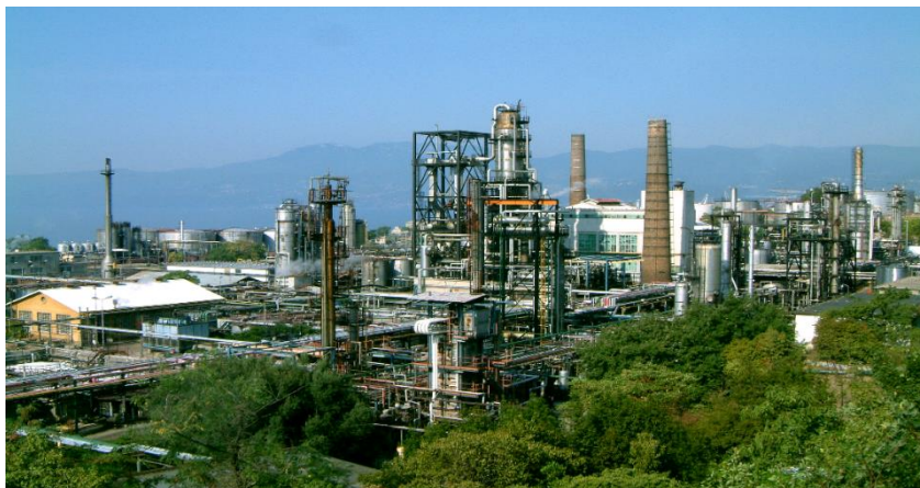
Slika 1. Rafinerija nafte Rijeka - Postrojenja Maziva – Mlaka [17]
