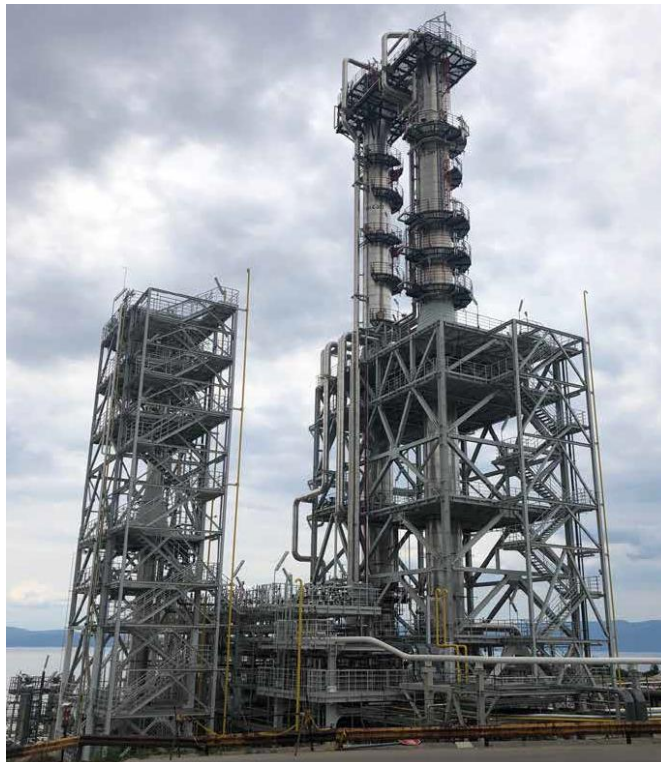
Slika 3. Novo postrojenje Propan propilen splitter [20]
