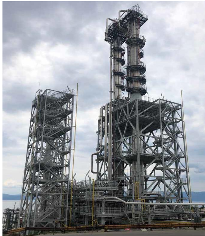
Slika 3. Novo postrojenje Propan propilen splitter [20]
