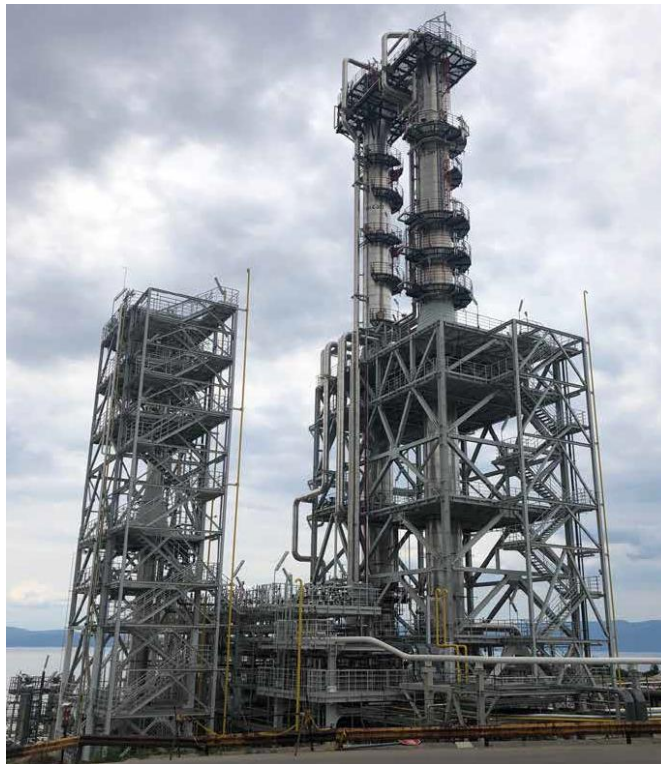
Slika 3. Novo postrojenje Propan propilen splitter [20]
