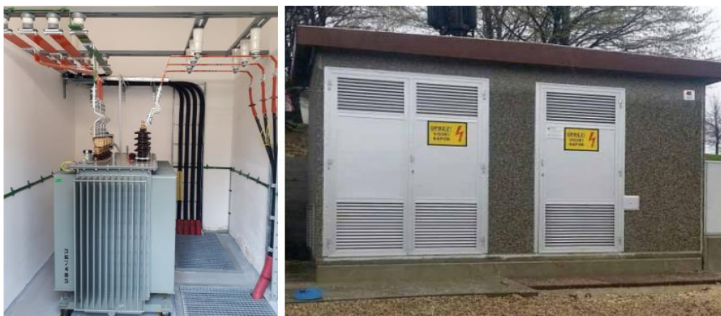
Slika 6: Karakteristična KTS/TS transformatorska stanica snage transformatora 1000 kVA
