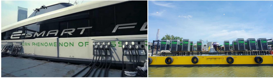
Slika 21: Ručni sustav povezivanja kopnenog priključka na ro-ro putničkom brodu „MINE Smart Ferry“; Energetski kabeli, utikači i utičnice (lijevo), sučelje kopnenog priključka (desno) Izvor: Adaptirano iz [89], [90]
