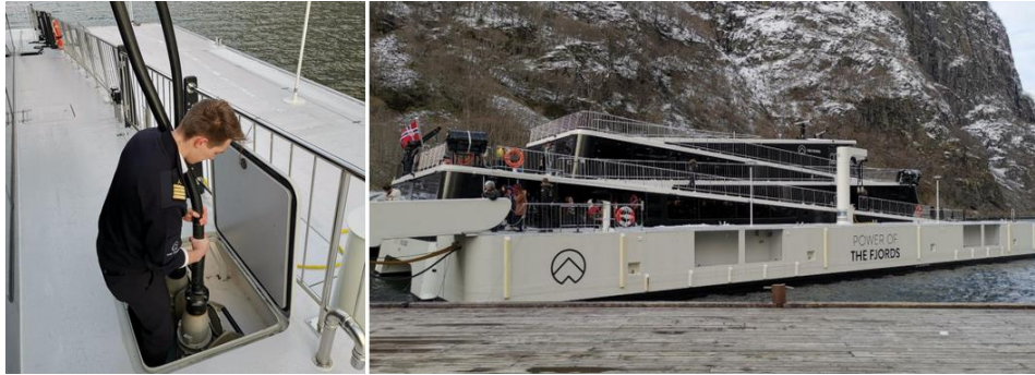
Slika 22: Ručni sustav povezivanja kopnenog priključka na turističkom putničkom brodu „Future of the Fjords“; Energetski kabele, utikači i utičnice (lijevo), kopneni priključak ugrađen u plutajući pristan (desno)
