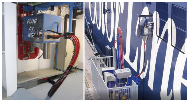
Slika 23: NG3 PLUG automatsko sučelje sustava kopnenog priključka na ro-ro putničkom brodu „MS Color Magic“; Brodski dio sučelja (lijevo); Kopneni dio sučelja (desno)
