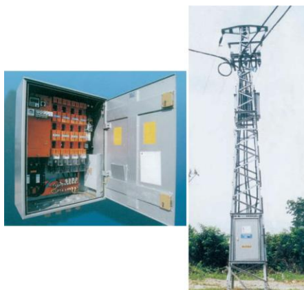
Slika 7: Karakteristična stupna transformatorska stanica na čelično-rešetkastom stupu i niskonaponski razvodni ormarić Izvor: Adaptirano iz: [67]
