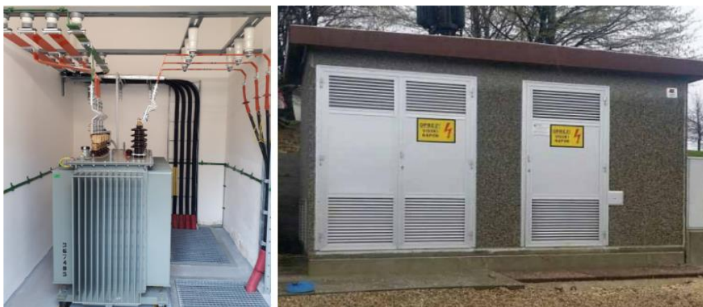
Slika 6: Karakteristična KTS/TS transformatorska stanica snage transformatora 1000 kVA
