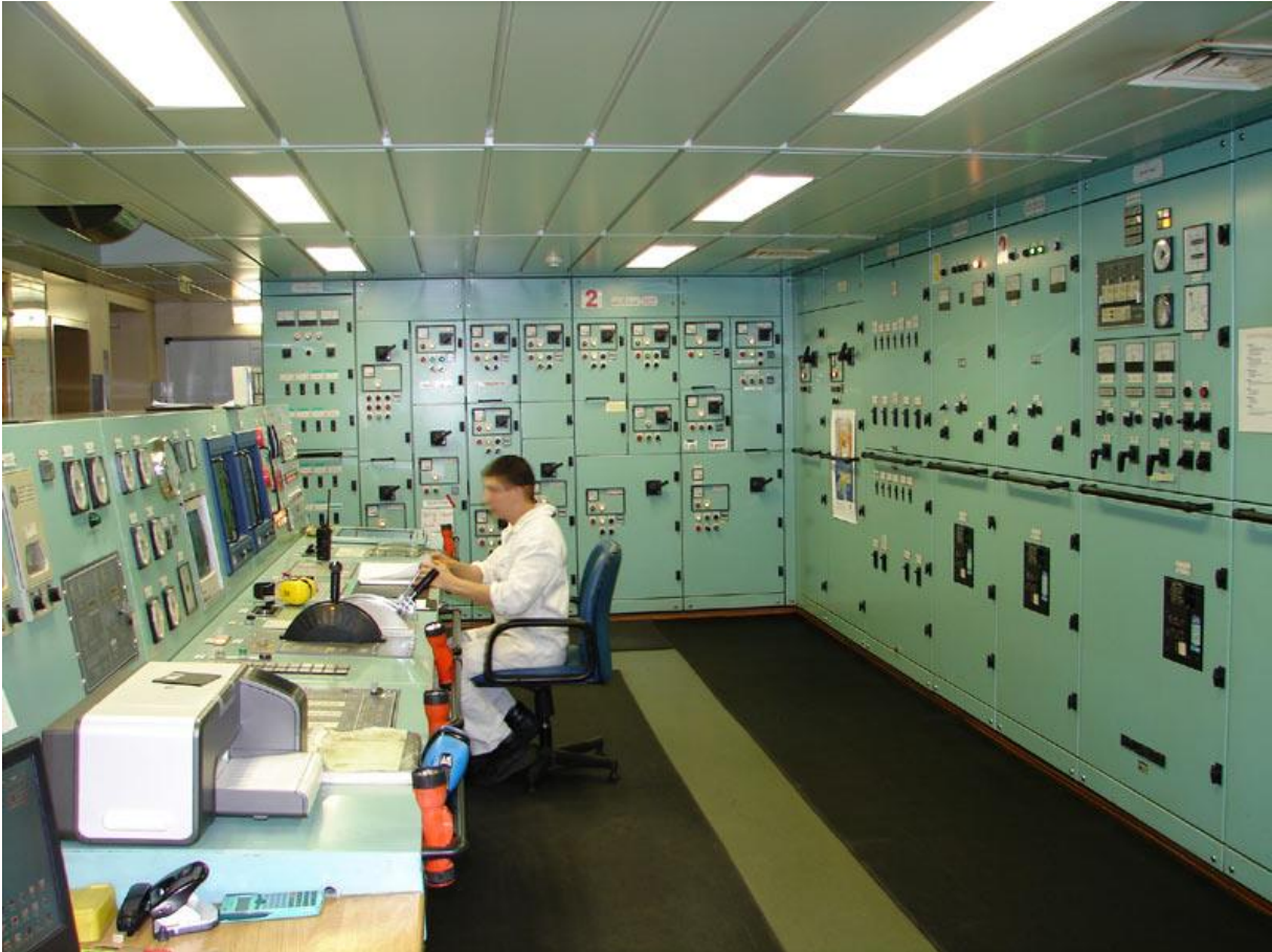
Slika 5.: Strojarnica broda za prijevoz tekućeg tereta ( Engine room )
