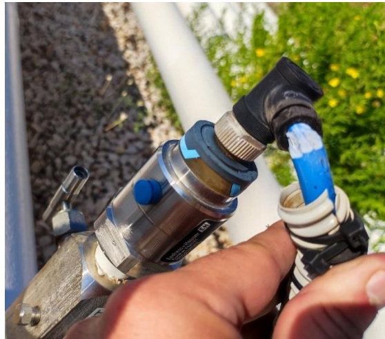
Slika 21.Primjer: Nedostatak – oštećeni instrumentalni kabel
