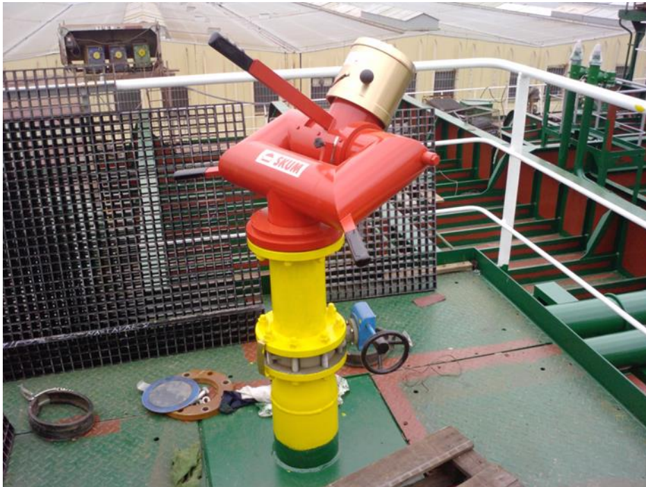
Slika 8 Monitor za gašenje požara na palubi
