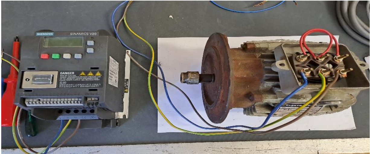
Slika 23: Prikaz spojenoga motora kao izlaz iz pretvarača frekvencije
