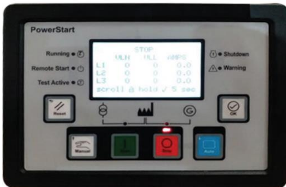
Slika 17: Primjer upravljačke ploče dizel generatora
