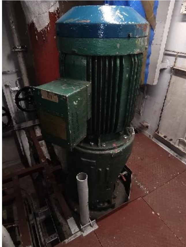
Slika 8. Jedna od pet trofaznih asinkronih motora odnosno pumpi.
