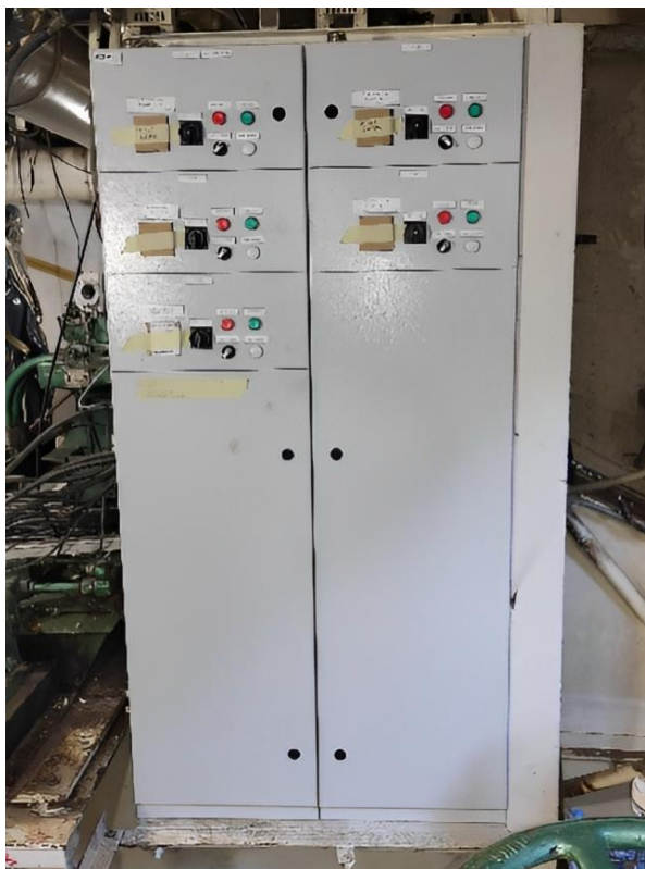
Slika 34. Ormari montirani na operativno mjesto.
