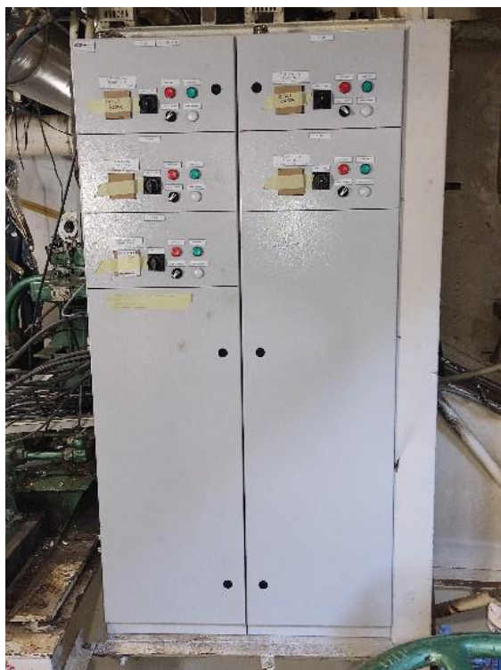
Slika 1. Kabinet za upravljanje elektromotorom
