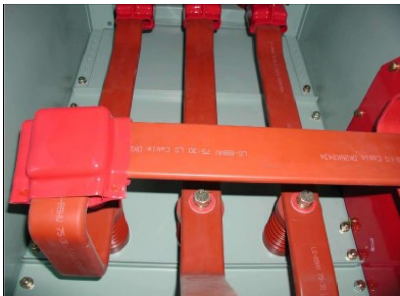
Slika 10. Sabirnice visokonaponske ploče
