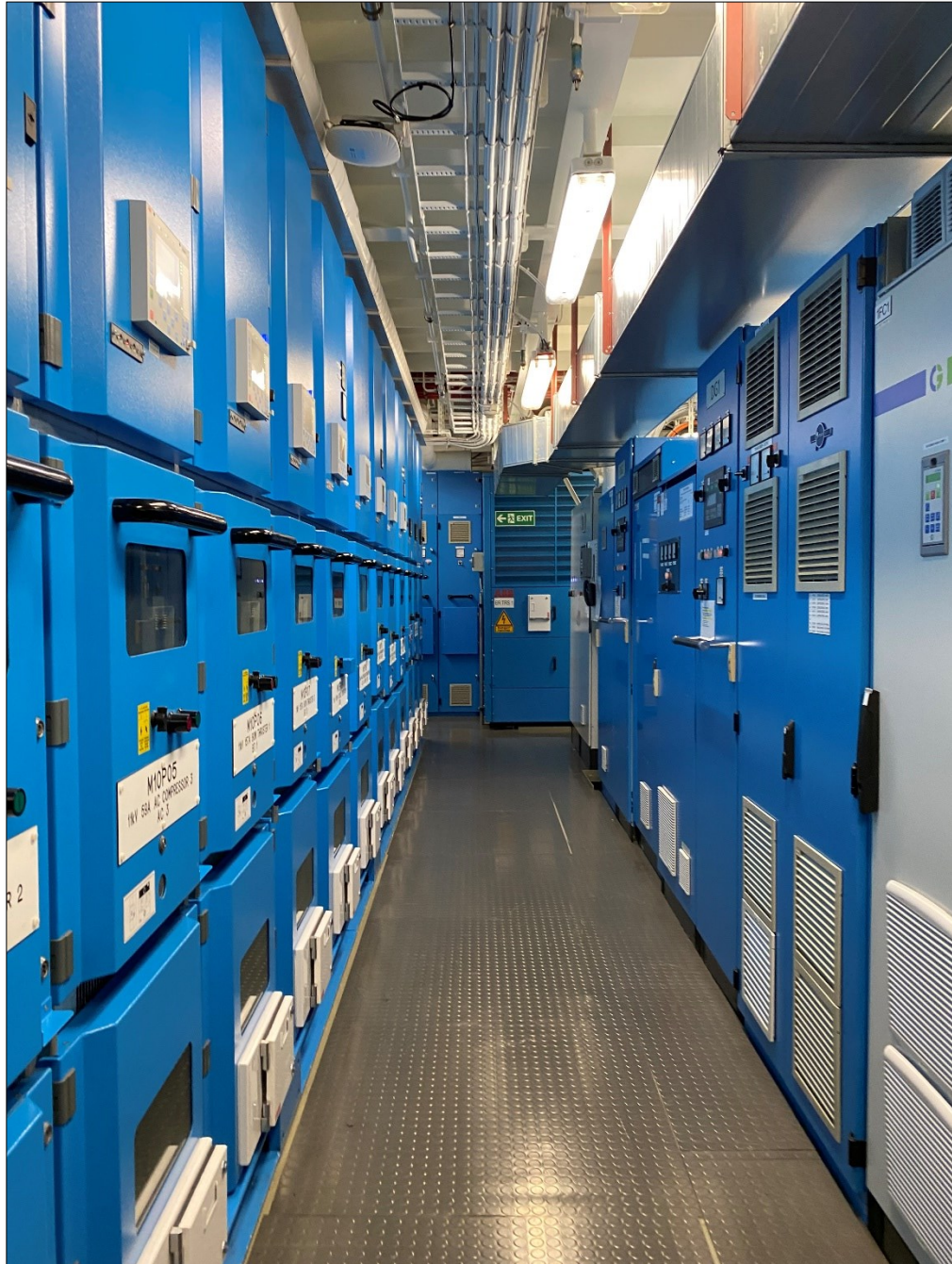
Slika 27. Smještaj visokonaponskih ploča Norwegian Gem broda
