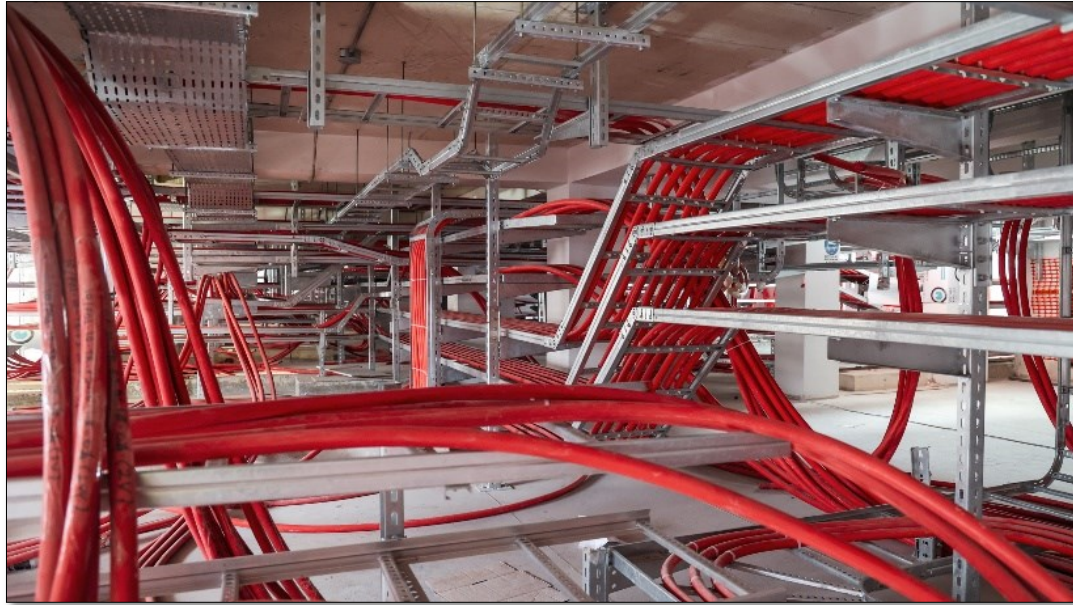
Slika 16. Visokonaponska kabela mreža
